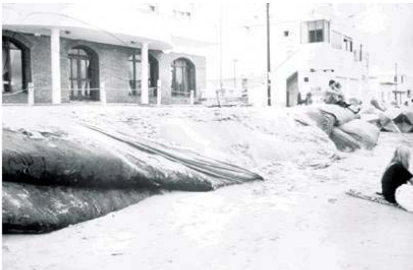
Figura 4: Deterioro de las estructuras de geotextil
